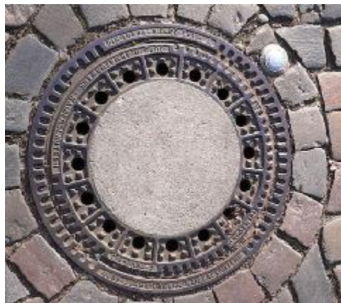
شکل 1-2- دریچه‌ای در شهر برلین که طبقه بندی بارگذاری D۴۰۰ و استاندارد DIN روی آن حک شده است.
